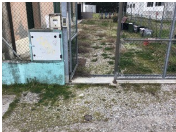
Sala prove via Stradello – assenza di percorso accessibile
