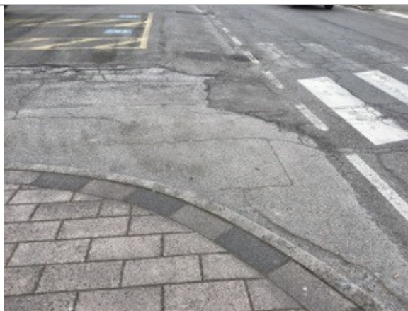
Via della Chiesa – assenza di percorsi pedonali sicuri in corrispondenza dei parcheggi riservati, di segnaletica podotattile di orientamento in corrispondenza dell'attraversamento, pavimentazione sconnessa
