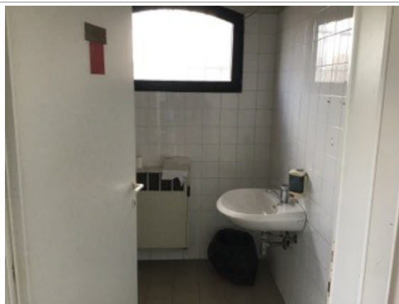
Palazzo di Villanova – l'unico servizio igienico attualmente raggiungibile, posto al piano terra, non risulta accessibile
