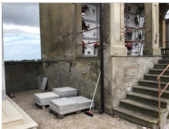
Cimitero Villanova – assenza di collegamento accessibile tra le due quote, mancanza di differenziazione cromatica e segnaletica podotattile di orientamento sulle scale, pavimentazione in ghiaio sciolto non fruibile
