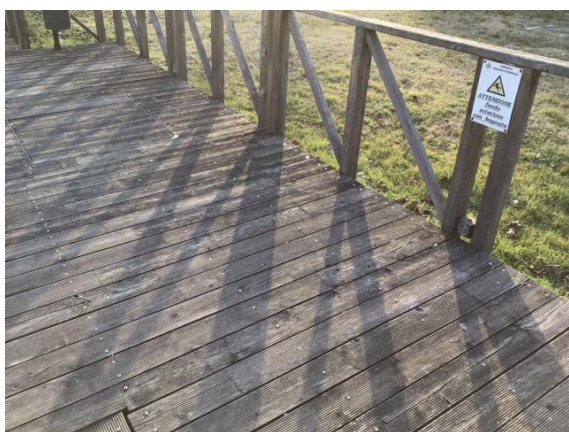
Viale Giacomo Matteotti – particolare del percorso con pavimentazione in listelli di legno con cartello di avviso che ne indica la scivolosità quando bagnato
