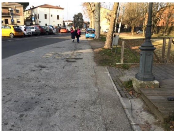
Via Pilastrino – la fermata del TPL ha la segnaletica orizzontale degradata, palina non intelligente posta sul manto erboso, mancanza di piattaforma di attesa e di segnaletica di orientamento tattile
