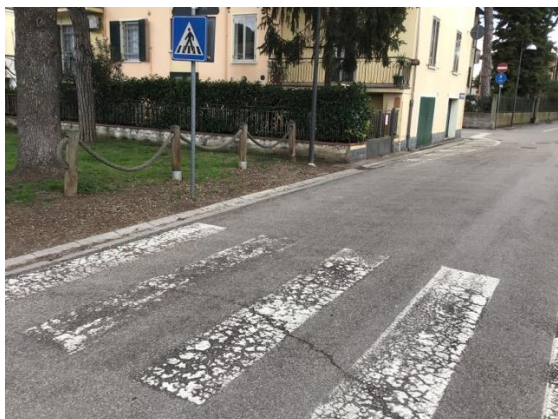
Corso Sforza- il marciapiede che costeggia il parco della torre dell'Acuto è in ghiaio e terra, inoltre mancano le rampe di collegamento con la strada nell'attraversamento pedonale
