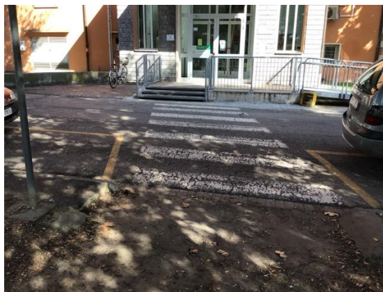
Via Cairoli – attraversamento davanti all’ingresso dell’ULSS, diverse sconnessioni e mancanza marciapiede su un lato
