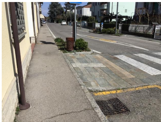
Via Manzoni Barbiano – esempio di segnaletica tattile incompleta, il pedone in transito sul marciapiede non rileva le linee di intercettazione
