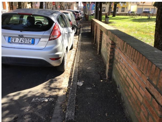
Via Cairoli – marciapiede stretto e molto sconnesso
