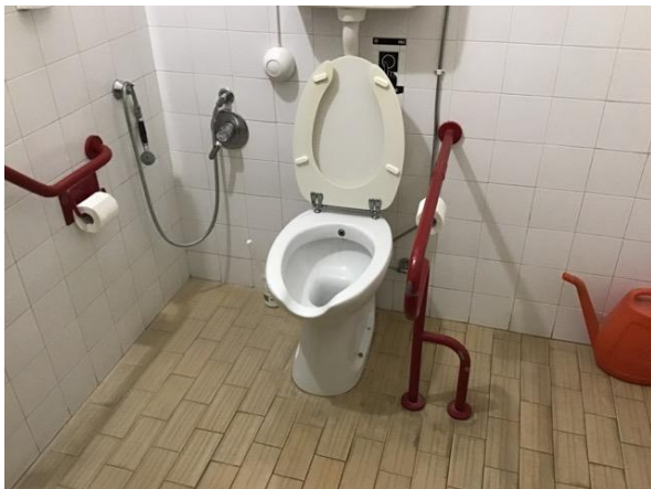
Municipio – Maniglioni inadeguati per forma e posizionamento
