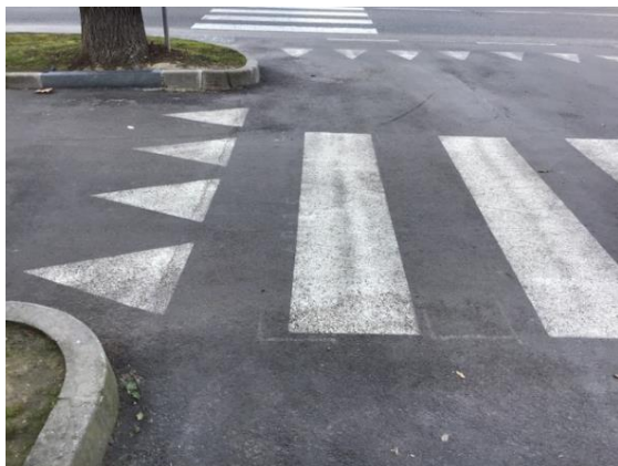
Viale Zaganelli – attraversamenti pedonali e sede carrabile promiscui, con segnaletica poco chiara
