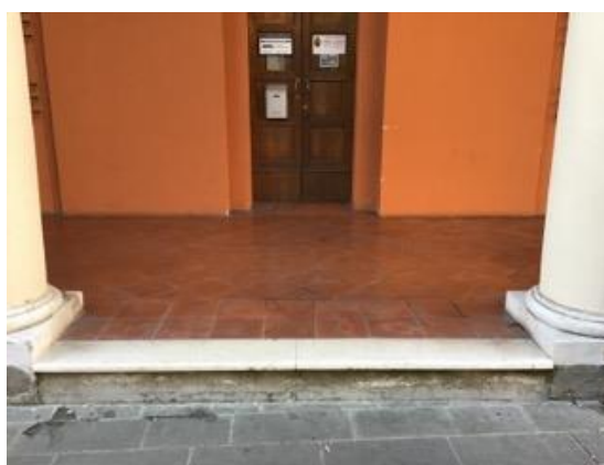
Municipio –Ingresso uffici delle associazioni con presenza di gradino non raccordato tra il percorso pedonale ed il porticato
