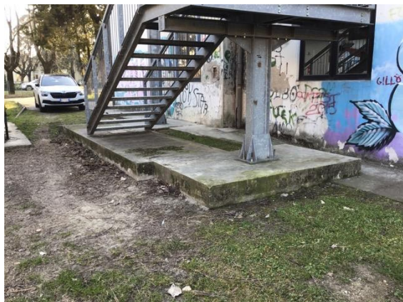
Centro Culturale ex JYL – Sporto metallico della scala di sicurezza che rappresenta un pericolo
