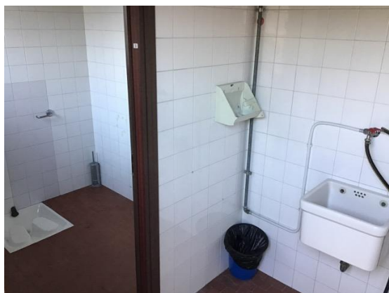
Cimitero – assenza servizio igienico accessibile
