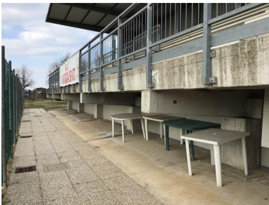
Stadio – solaio e pilastri della tribuna sporgenti e pericolosi
