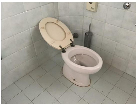
Casa Contadini Centro Sociale – assenza di maniglioni a lato della tazza wc e mancanza di schienale
