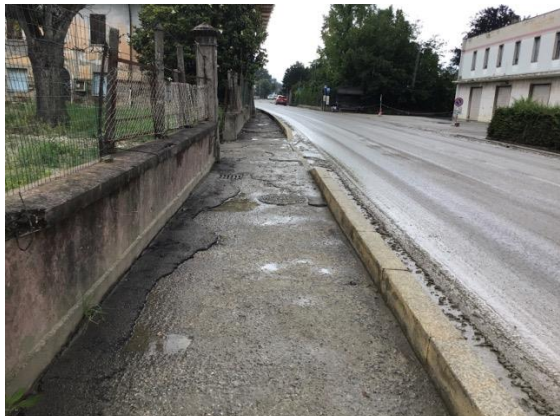
Via San Vitale – sconnessioni peggiorate a causa dell'alluvione, forti pendenze trasversali presenti anche prima delle alluvioni.
