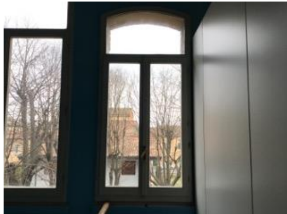
Scuola Pascoli – finestre in legno obsolete e pericolose in quanto hanno un'apertura solo a libro
