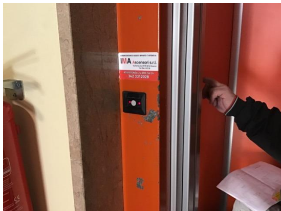
Municipio – assenza di pulsantiera e targa tattile in braille all'interno e all'esterno dell'ascensore, mancanza di segnaletica sonora di arrivo al piano
