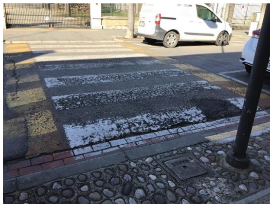
Via Roma – dettaglio del raccordo tra attraversamento pedonale e marciapiede, non accessibile per presenza di contropendenza e di pavimentazione in ciottoli non accessibile
