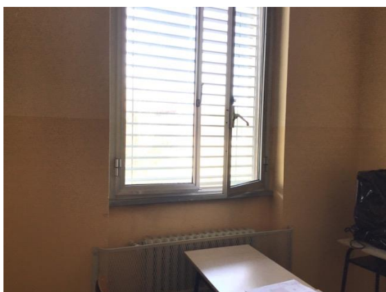
Scuola elementare di Lavezzola – serramenti dell'intero edificio in alluminio con spigoli vivi, proposta l'integrale sostituzione
