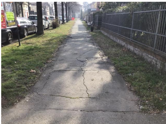
Via Roma – sconnessione della pavimentazione dovute alle radici affioranti degli alberi
