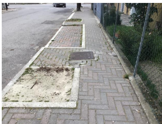
Via Don Luigi Minzoni – ostacoli e sconnessioni dovute alla presenza di aiuole e restringimenti del percorso.
