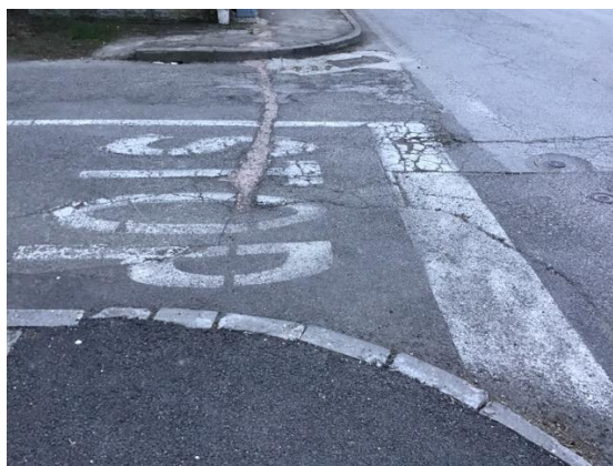
Via Selice – assenza di un attraversamento pedonale, salti di quota non raccordati con delle rampe
