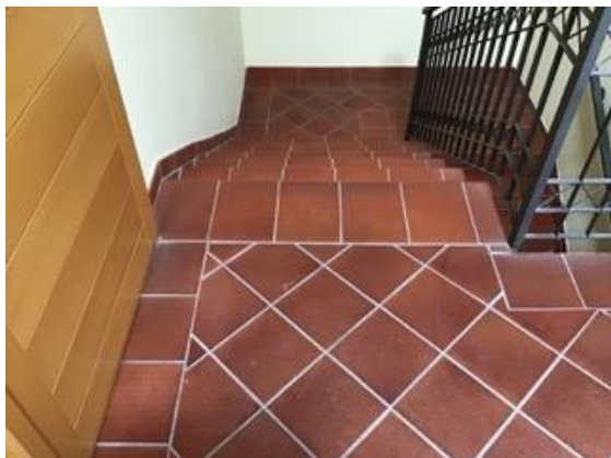
Municipio di Conselice – assenza di segnaletica tattile a pavimento per segnalare la presenza della scala alle persone con disabilità visive
