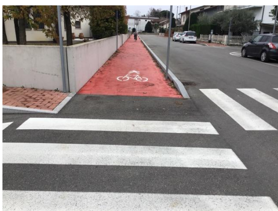
Via Murri – percorso ciclopedonale a raso evidenziato con contrasto cromatico | manca la segnaletica tattile di orientamento
