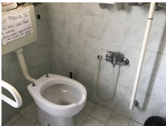
Casa in Comune – tazza wc con maniglione ribaltabile sul lato corretto e verticale da sostituire con uno orizzontale e fisso a parete
