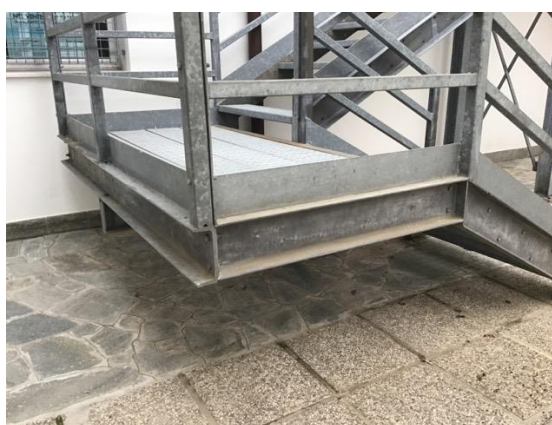
Biblioteca – La scala di sicurezza dal primo piano del Museo risulta pericolosa in quanto gli spigoli vivi della struttura sono ad altezza bambino
