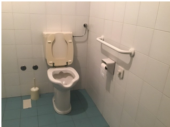
Museo San Rocco – assenza di maniglione ribaltabile su lato della tazza e posizione inadeguata di quello fisso a parete (troppo in alto)
