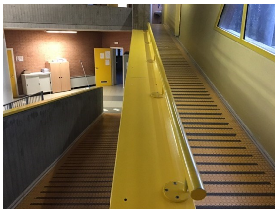
Scuola primaria – rampe inadeguate per lunghezza, mancanza di piazzole di sosta ogni 10 metri e quantità insufficiente di corrimano
