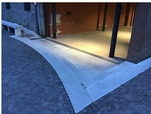
Piazza Mazzotti – presenza di gradini non adeguatamente segnalati tattilmente e cromaticamente
