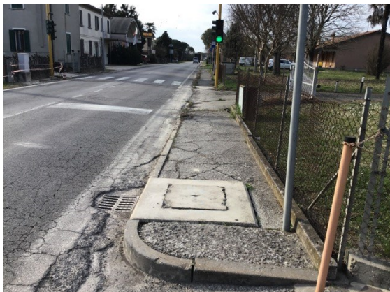
Via Maiano – percorso pedonale sconnesso e con presenza di gradini non raccordati
