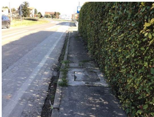
Via San Savino – percorso pedonale che conduce alla fermata del TPL con fondo molto sconnesso e stretto
