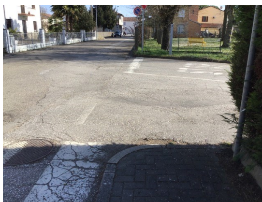
Via Rossetta Traversa – mancanza di percorsi e attraversamenti pedonali
