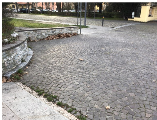
Piazza Battista Emaldi – assenza di percorso pedonale di collegamento tra i marciapiedi e l'accesso al parco
