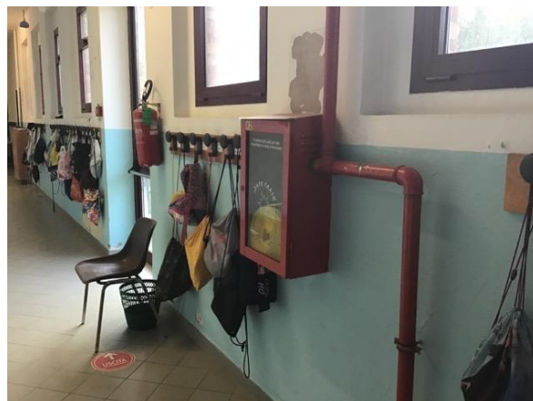
Scuola primaria L. Quadri – presenza di cassette antincendio con spigoli vivi lungo i corridoi
