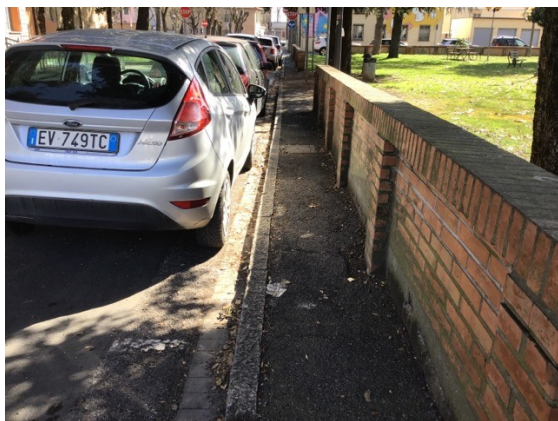
Via Cairoli – marciapiede stretto e molto sconnesso
