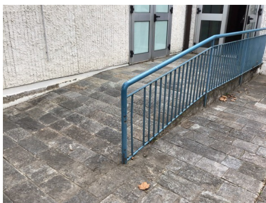
Scuola materna di Cotignola – rampa con pendenza longitudinale non conforme superiore all'8%
