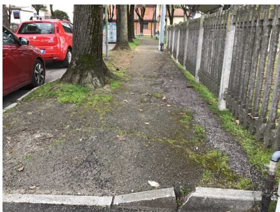
Via Vassura – sconnessione della pavimentazione dovute alle radici affioranti degli alberi
