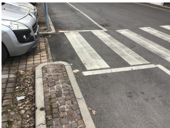
Via Matteotti – attraversamento privo di segnaletica podo-tattile, auto parcheggiate che ne impediscono l'utilizzo
