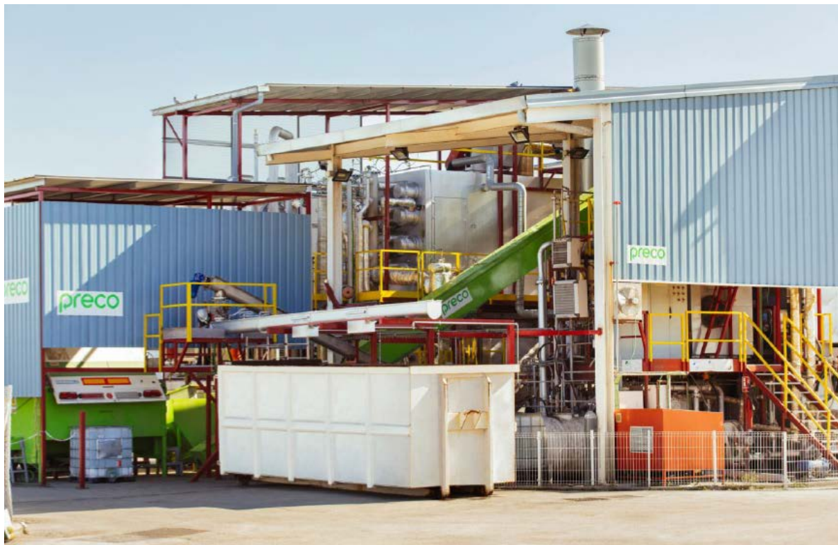
Immagine dell'impianto di Pirolisi operante all'Ecoparco di Toledo
